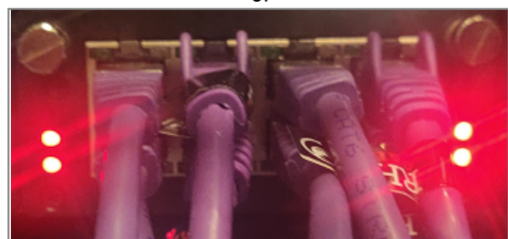
Mécanisme de bypass déclenché
