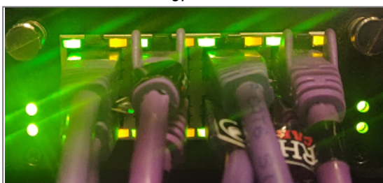
Mécanisme de bypass non déclenché
